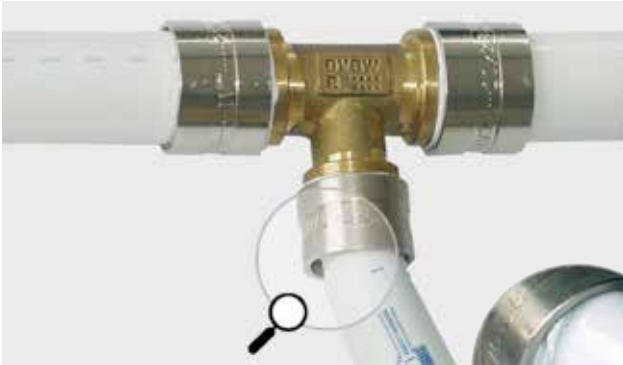
Unzulässiges Biegen direkt an der Verbindung
