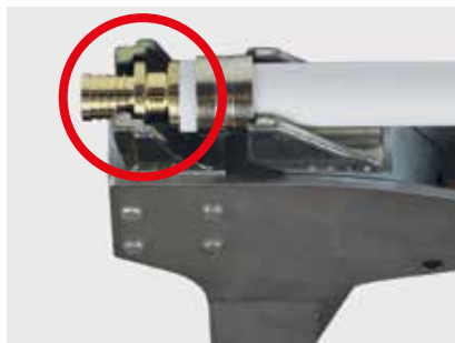
Schiebebacke F am falschen Fittingbund angesetzt. Verbindung wird dadurch überpresst.
